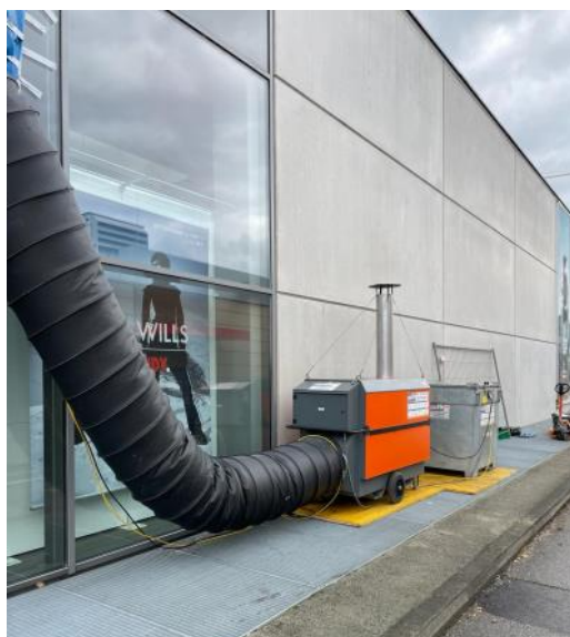
Notbeheizung Geschäftslokal K 160
