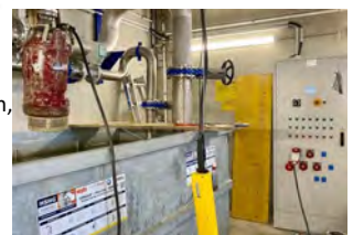
Service, HSHG-Prüfbock für Pumpen
