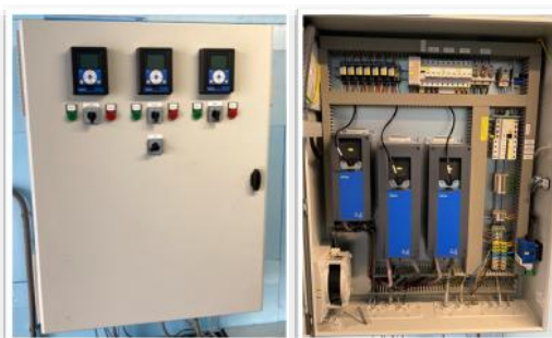
HSHG-Schaltschrank - Wasserversorgung mit Frequenzumrichter
