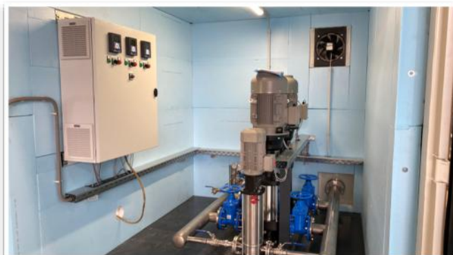
HSHG-Container - Wasserversorgung für Tunnelbohrmaschine
